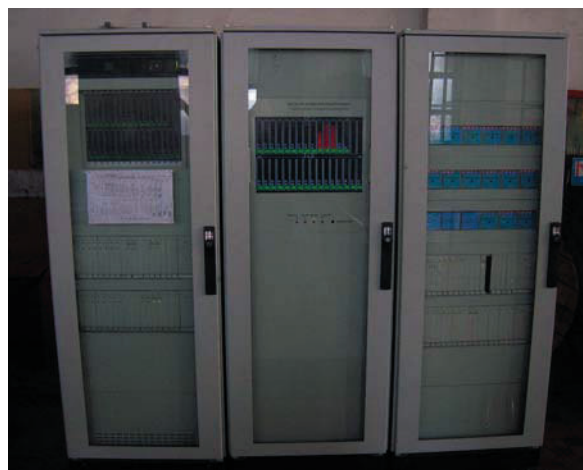
Рис. 8. Шкафы программируемых контроллеров и системы резервной индикации
