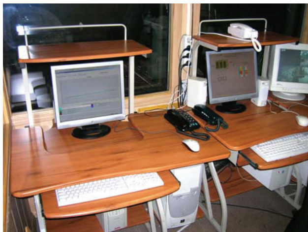
Рис. 4. Автоматизированные рабочие места дежурного персонала станции
