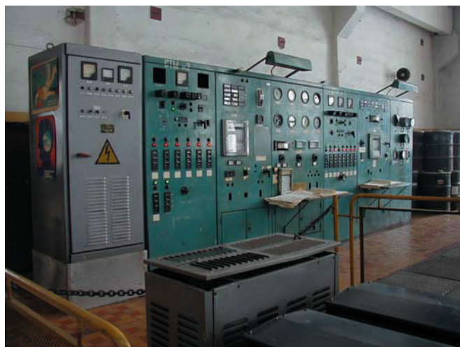
Рис. 2. Пульт управления агрегатами ТКС
