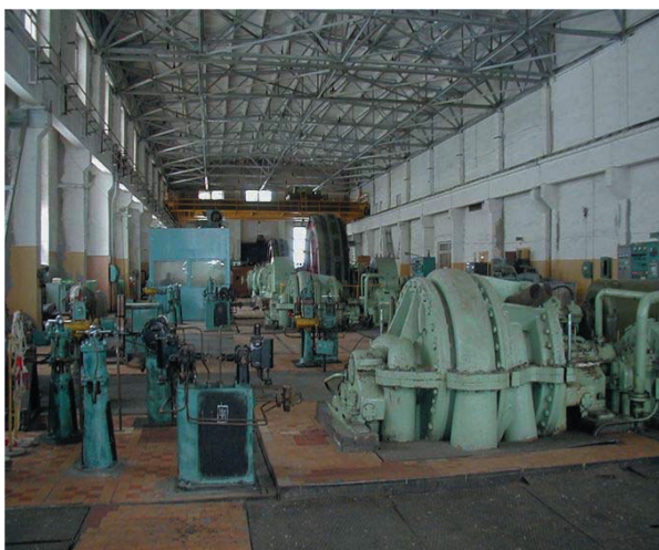
Рис. 1. Машинный зал турбокомпрессорной станции
