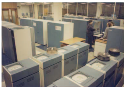
Рис. 9. В зале оборудования ЭВМ ЕС
